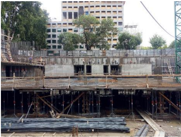
Vista de la Torre 2 donde se ven la losa s/3 ss y s/2ss
